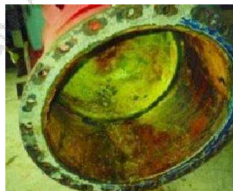
搪瓷玻璃衬里的腐蚀
